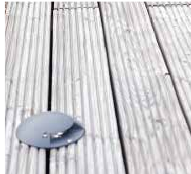
Verlichting in houtwerk, tussen 2 brugdek delen
